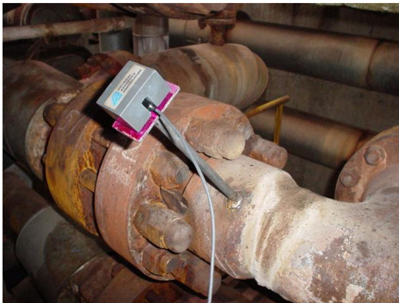
Рис. 4. Слежение за ростом дефекта в шве патрубка.
